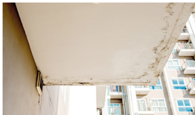
Infiltrazioni in balcone
