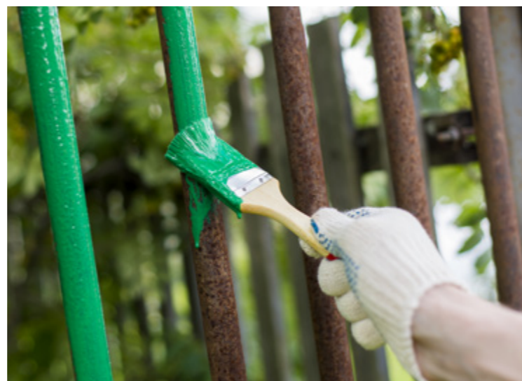
Manutenzione con trattamenti specifici antiruggine per i comuni parapetti in metallo, per evitare che gli stessi vengano corrosi dal tempo, perdendo bellezza e sicurezza.
